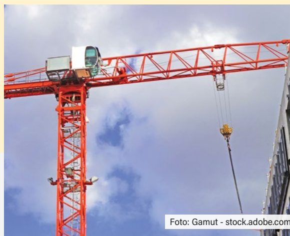
Kranbetrieb oder Montage von Fertigbauteilen bei Unwetter (starker Wind oder Sturm und Gewitter).
